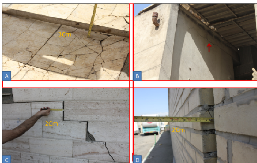
شکل ۸ آسیب پذیری سکونتگاه‌ها A: پایین رفتن کف ساختمان حدود ۳ سانتی متر B: خم شدگی دیوار به بیرون به میزان ۲ سانتی متر C: ایجاد ترک عمودی به میزان ۲ سانتی متر D: ایجاد ترک افقی در ساختمان
