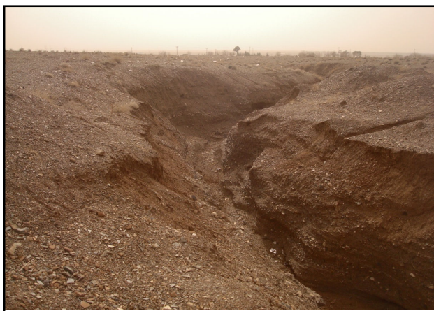
شکل ۹ آبشستگی بستر در پل کیلومتر ۲۰۰+۶۶۷ در مسیر شادمهر به تربت حیدریه
