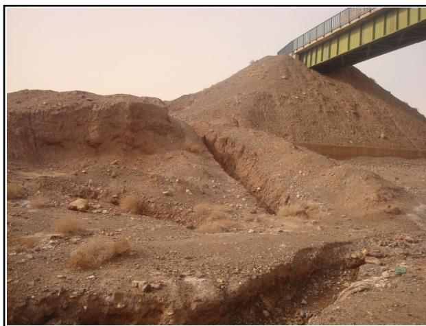
شکل ۸ آبشستگی بستر در پل کیلومتر ۲۰۰+۶۶۷ در مسیر شادمهر به تربت حیدریه
