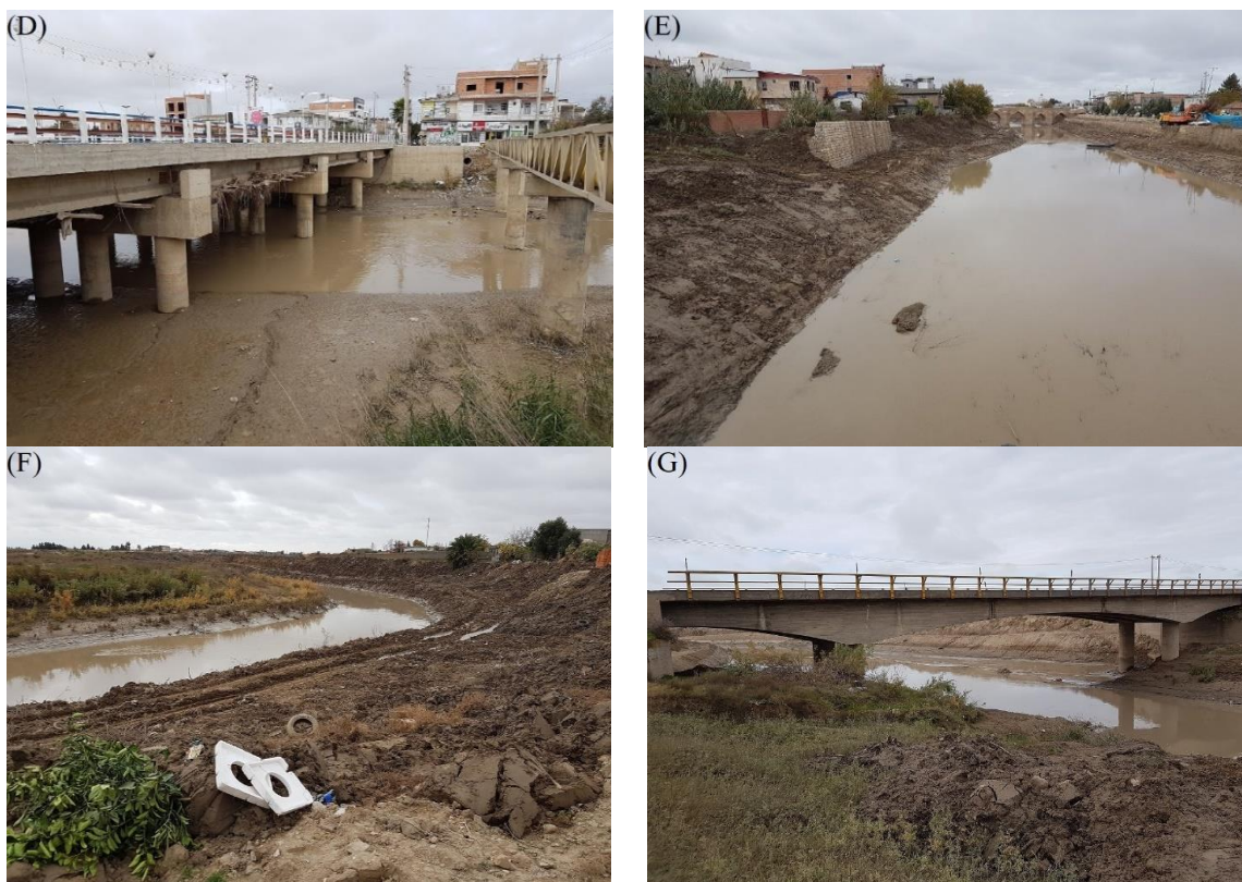
شکل ۷- تصاویر میدانی گرفته شده از بازه‌های مورد مطالعه؛ (B) مسیر رودخانه در بازه اول در نزدیکی روستای سلاق یلقی، (C) پل نامناسب در مسیر رودخانه در بازه دوم در نزدیکی شهر آق‌قلا، (D) تراز کف نامناسب پل و عدم لایروبی رودخانه در بازه سوم شهر آق‌قلا، (E) عدم دیواره‌سازی مناسب رودخانه در بازه سوم پل تاریخی آق‌قلا، (F) نبود شیب مناسب و تخلیه نخاله در حریم رودخانه و عدم دیواره‌سازی کانال در بازه چهارم، (G) تغییر شدید عرض رودخانه و شیب نامناسب و عدم لایروبی رودخانه در بازه چهارم (منبع: نگارند، ۱۳۹۸)
