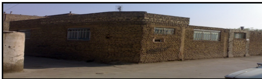
شکل ۷ حذف اعضای سازه‌ای در ساختمان مسکونی
