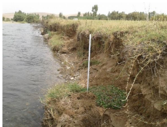
شکل ۱۸ فرسایش کناره ناشی از سیلاب مهرماه سال ۱۳۹۳
