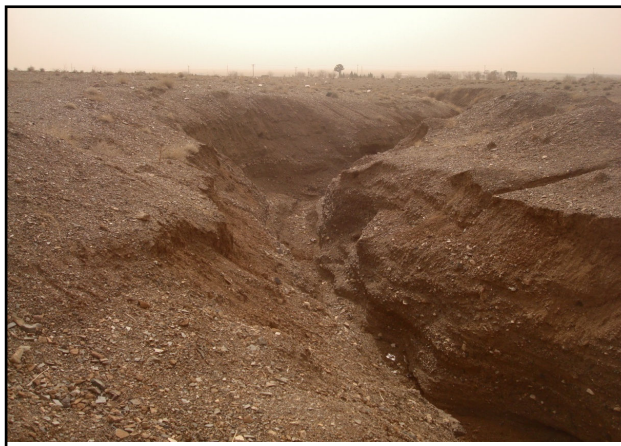
شکل ۹ آبستنگی بستر در پل کیلومتر ۲۰۰+۶۶۷ در مسیر شادمهر به تربت حیدریه
