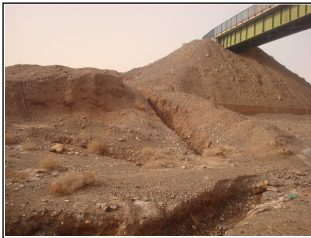
شکل ۸ آبستنگی بستر در پل کیلومتر ۲۰۰+۶۶۷ در مسیر شادمهر به تربت حیدریه
