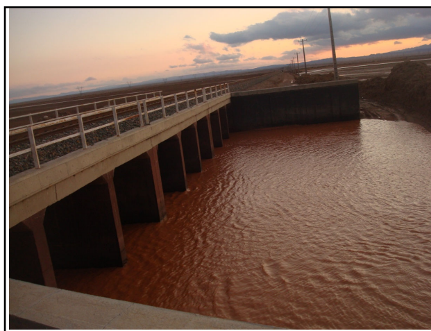
شکل ۱۰ تجمع آب در زیر پل کیلومتر ۱۰۰+۳۲۱ از نمکزار به طبس
