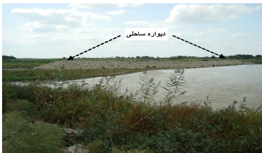
شکل ۷- نمونه‌ای از دیوار ساحلی حفاظتی ساخته شده توسط شرکت آب منطقه‌ای استان اردبیل در بازه محمد رضالو
