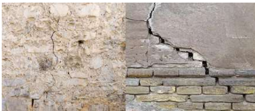
شکل ۸- ترک‌های شکل گرفته ناشی از فرونشست در دشت اردبیل
