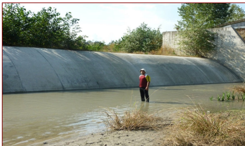
شکل ۳ شکستگی بستر رود و احداث آبخار کوچک بر روی آن
