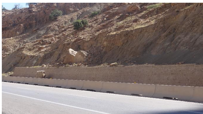
شکل ۹. پر شدن پشت دیواره‌های حائل و بلوک‌های سیمانی توسط سنگ‌های ریزشی در کیلومتر ۸۴ آزادراه
