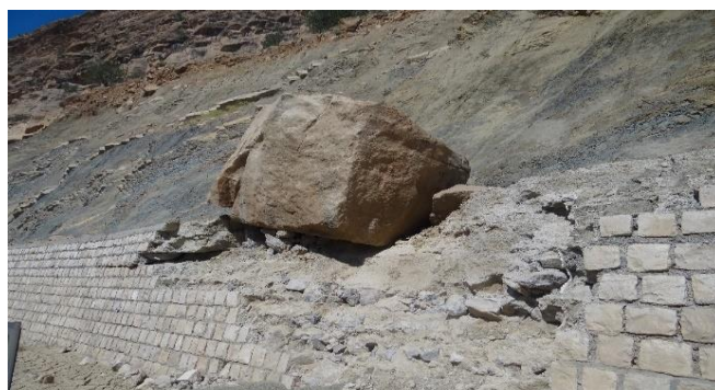
شکل ۱۰. تخریب دیواره‌های حائل اطراف جاده توسط تخته سنگ‌های ریزشی در کیلومتر ۸۴
