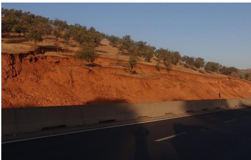
شکل ۳. زمین‌لغزش فعال و بزرگ بخش اول در کیلومتر ۱۶ مسیر که توسط دیوار حائل احاطه شده است.
