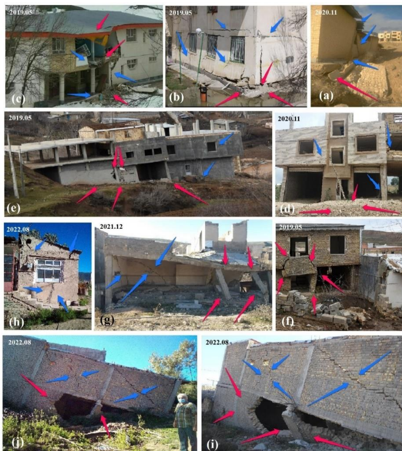
شکل ۸ - تصاویر آسیب به ساختمان‌های پهنه لغزشی حسین‌آباد. تصویر (a) ساختمان شماره ۱۱ با میزان خسارت 3C، تصویر (b) ساختمان شماره ۱۶ با میزان خسارت 3B، تصویر (c) ساختمان شماره ۱۸ با میزان خسارت 3C، تصویر (d) ساختمان شماره ۲۲ با میزان خسارت ۲، تصویر (e) ساختمان‌های شماره ۲۸، ۲۹ و ۳۰ به ترتیب با میزان خسارت 3B، 3B و ۲، تصویر (f) ساختمان شماره ۴۷ با میزان خسارت 3B، تصویر (g) ساختمان شماره ۶۱ با میزان خسارت 3C، تصویر (h) شماره ۶۵ با میزان خسارت ۲، تصویر (i) و (j) ساختمان شماره ۶۴ با میزان خسارت 3C. پیکان قرمز رنگ نیروی فشاری، بالا آمدگی و شکست و پیکان آبی رنگ ترک عادی و با زاویه ۴۵ درجه.
