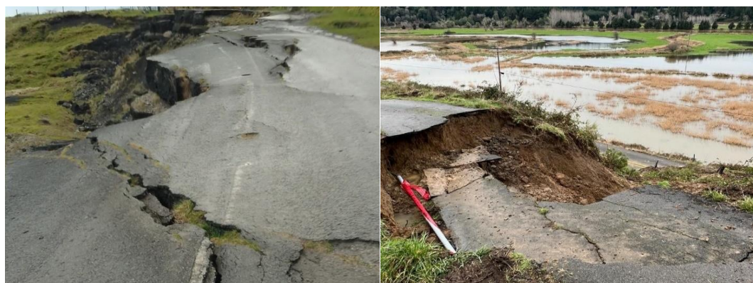
شکل ۱۵- رخداد زمین لغزش در شالیزارهای اطراف شهر آستارا Fig.15. Landslide Occurrence in the Rice Fields Surrounding Astara City
