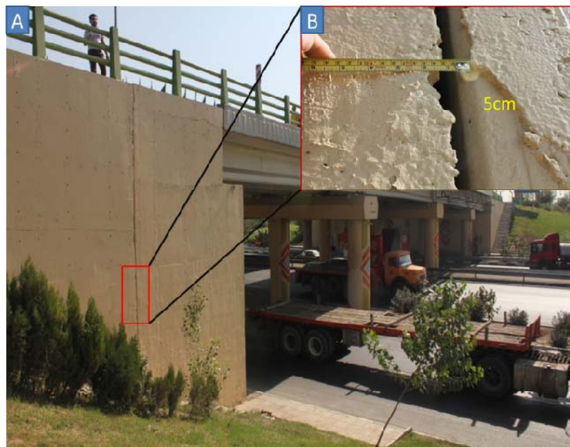
شکل ۹ آسیب پذیری پل آزادگان (تقاطع بزرگراه شهید رجایی و بزرگراه آزادگان) A: ایجاد شکستگی عمودی در گوشواره ابتدای پل به میزان ۵ سانتی متر B: نمای نزدیک از شکستگی عمودی در پل آزادگان
